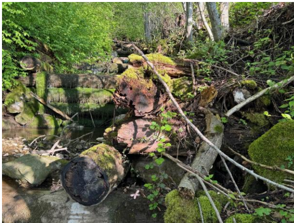
Abb. 3: Sperrenflügel, starke Fäulnis sichtbar
