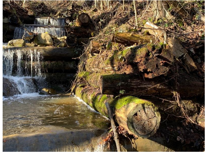
Abb. 2: Durch Fäulnis zerstörte Leitwerke
