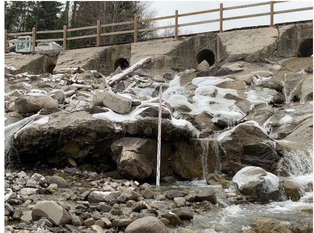
Erodierte Sohlensicherung der Furt
