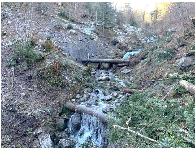
Ausgespülte Schwellen mit seitlicher Erosion
