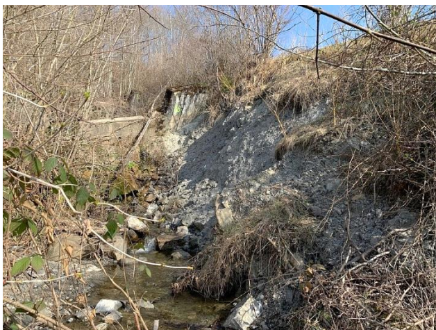
Rutschung im Gerinne
