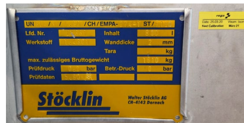
Bild 6: Beispiel einer Tankplakette und interner Prüfkleber (Inhalt weicht von Zwischenlagermenge ab)
