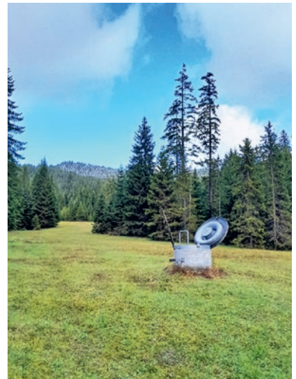
Druckbrecherschacht Lucht (Quellfassung Wolfetsmatt)
