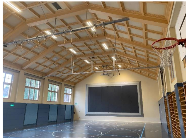
Neue LED-Deckenbeleuchtung Turnhalle 1 Sarnen
