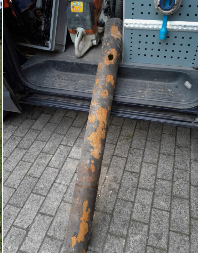
Defekte Hauptleitung Allmendstrasse
