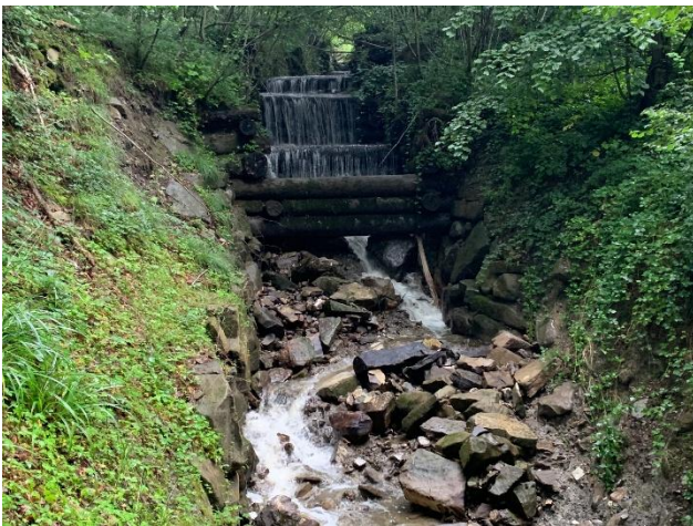
Schlimbach: Ausgespülte und unterkolkte Sperrre
