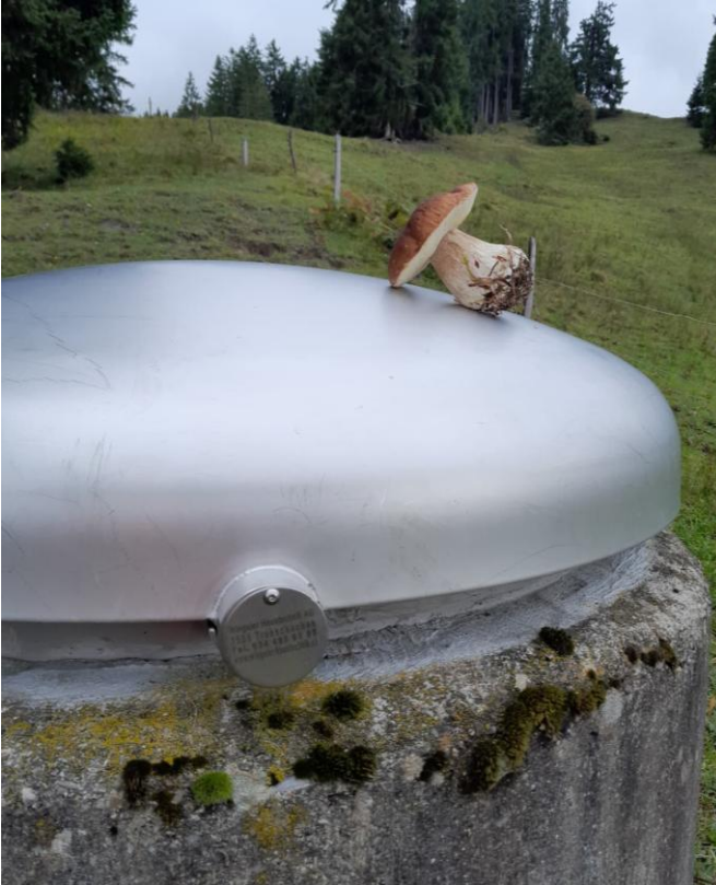
Pilzdeckel, Druckbrecherschacht Nienenhütte, Stalden
