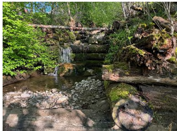
Foto 2: Durch Fäulnis zerstörte Leitwerke
