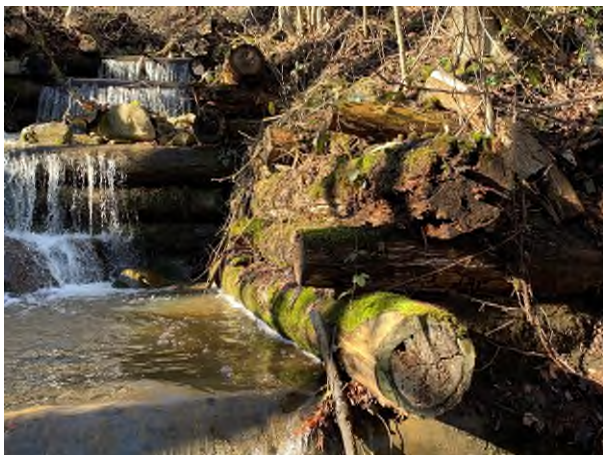
Foto 1: Abflusssektion mit verfaulten Leitwerken
