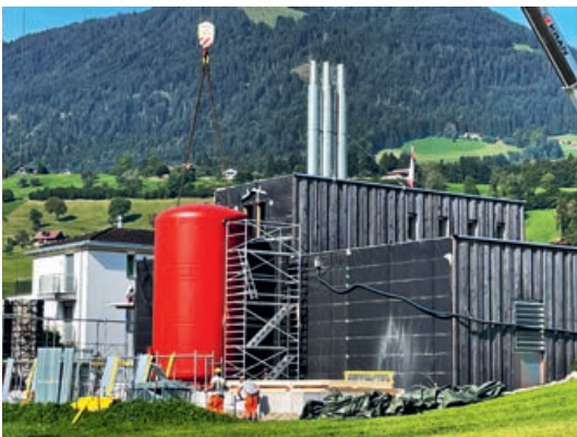
Platzierung des Speichers (Foto: Res Berchtold)
