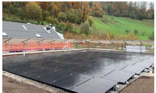
Fertig erstellte PV-Anlage auf Feuerwehrrhalle 2
